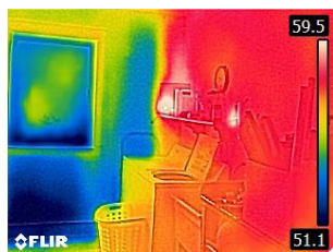
Parede externa não isolada
